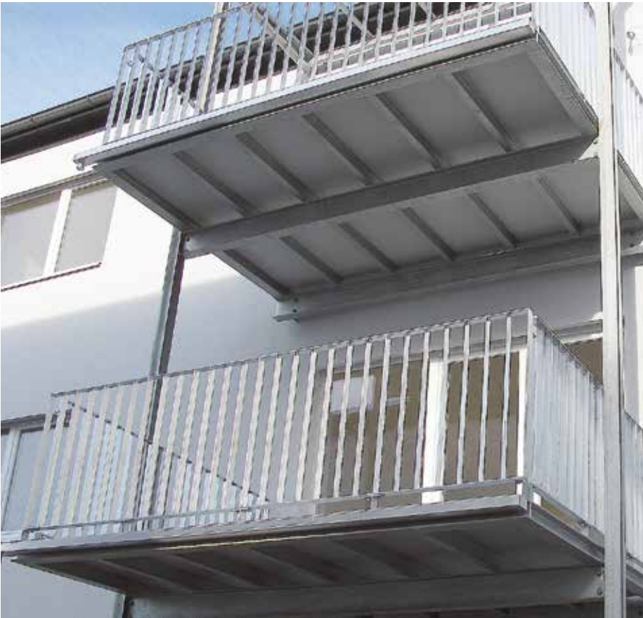
BALKONOVÉ PODLAHOVÉ DESKY; OBJEKT V ST. VEIT/GLAN, RAKOUSKO
